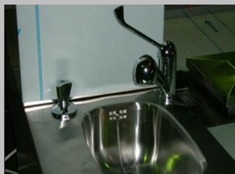
Spüle mit Ellbogen-Armatur und flexibler Brause (1,5 m). Links: Ventil für Ringspülsystem unterhalb der Arbeitsfläche
