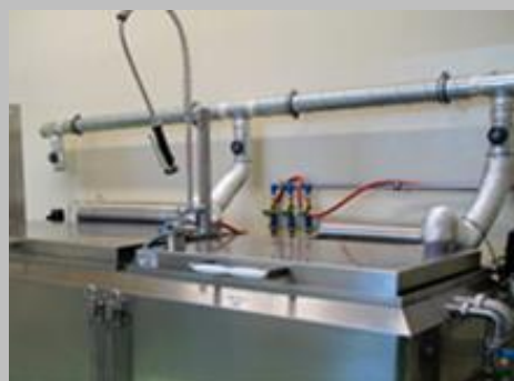
Beispiel bauseitiger Abluftleitung, der 3. offene Anschluss vermeidet einen Unterdruck in den Kammern
