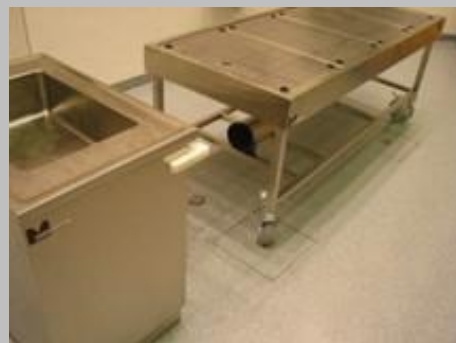
Abluftleitung vor der Verbindung mit der Andocksäule
